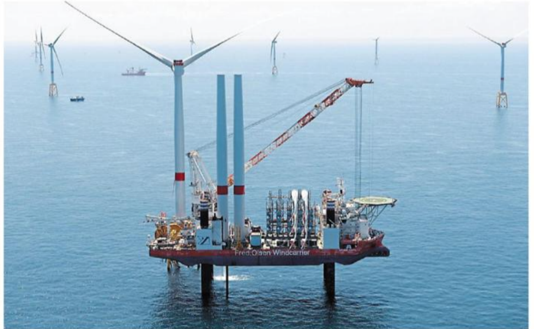
Les éoliennes, ici sur le chantier le 18 juillet, arrivent quatre à quatre sur ce bateau en provenance de l'usine Siemens du Havre.
