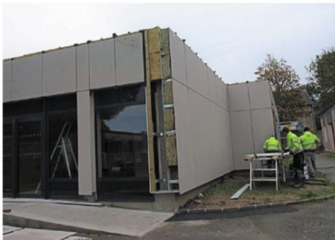
Les travaux d'isolation de l'école Joseph-Erhel, par l'extérieur, sont en cours de réalisation par l'entreprise Quémard.
