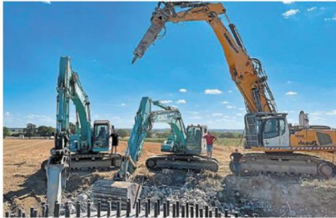
Des brises roches de 70 tonnes grignotent les 500 m 3 de béton de chaque socle d'éolienne
