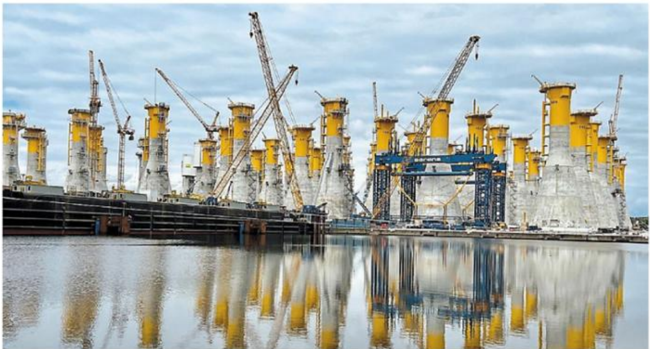
Sur le port du Havre, les soixante et onze embases gravitaires destinées au parc éolien de Fécamp.
