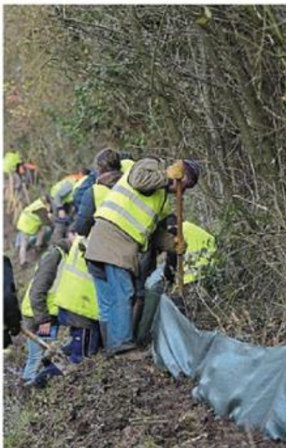
Pose d'une barrière-piège en bordure de la D28, pour aider les amphibiens à traverser la route, en 2016.
