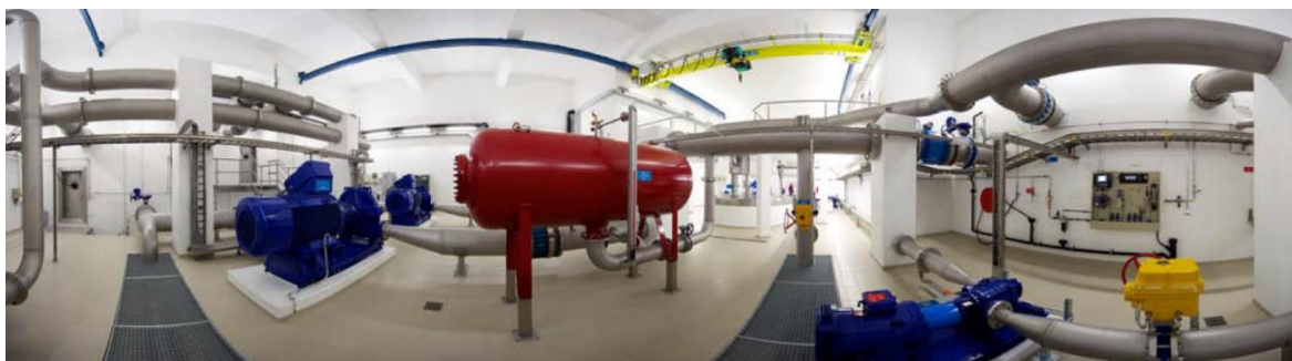
Station pompage Onnens
