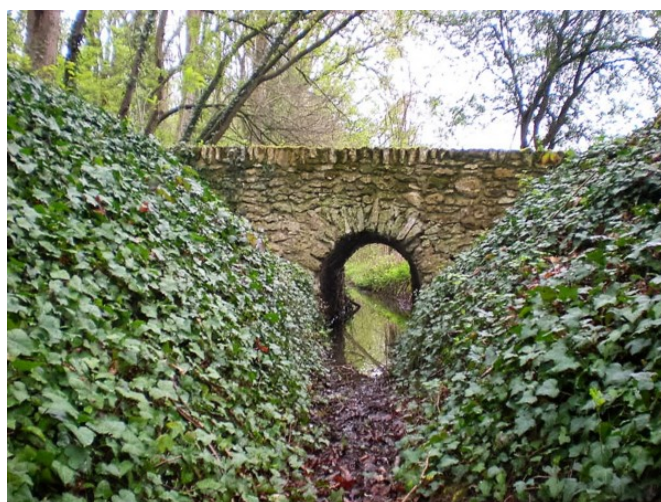
Le réseau technique sous le beau pont de la Fosse Renault restauré en 2007. (Photo D - 26 avril 2016).
