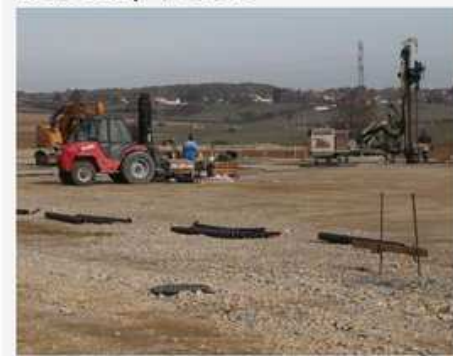
Les travaux de la ZAC Oasis 3 ont débuté début juillet. Photo Bruno GRANDJEAN
