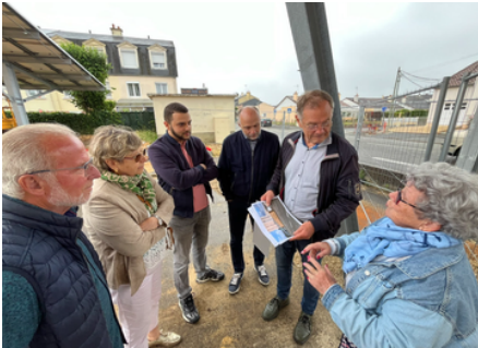
Visite du chantier des ombrières photovoltaïques des Mahonias à Vauguyon de Christophe COUNIL avec Jacques GOUFFÉ, Président de Cénovia. 1ère opération sur la parking d'une copropriété privée.
