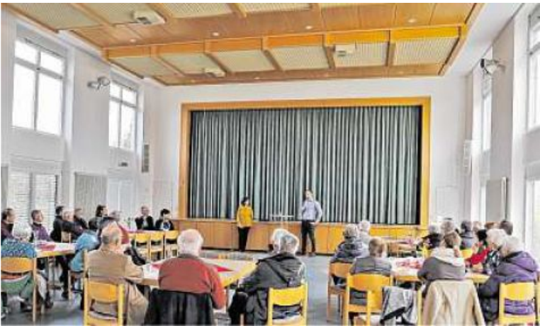
Wie hier bei der Pfarrversammlung zu sehen, sieht der Pfarrsaal durch bereits durchgeführte Schönheitsreparaturen rein optisch gut aus. Doch der Schein trügt. Die Wände ringsum weisen Feuchtigkeitsschäden auf.
