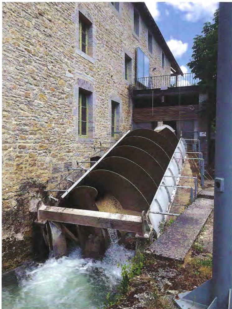
Au moulin de Cezi à Arbois (Jura), la vis hydrodynamique de 75 kW turbine 2,50 m de hauteur de chute brute et un débit de 0,4 à 4 m 3 /s, pour une production moyenne de 140 000 kWh/an. Photo : Benoît Gresset
