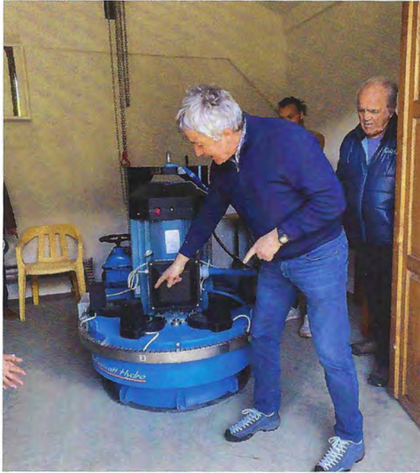
La centrale de Claude Glise à Villard-du-Planay (60 kW, Savoie), lors de son inauguration en avril 2024. La machine fait partie des 250 turbines Pelton installées par le turbinier italien Irem en France. Photo : Christophe Convert
