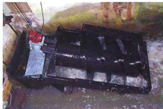
Le moulin de Beaumer, à Monts en Indre-et-Loire, a été l'un des premiers sites équipés d'une vis hydrodynamique en France, dans les années 2000. Avec une dizaine de kW de puissance, elle produit environ 50 000 kWh/an. Photo : DR
