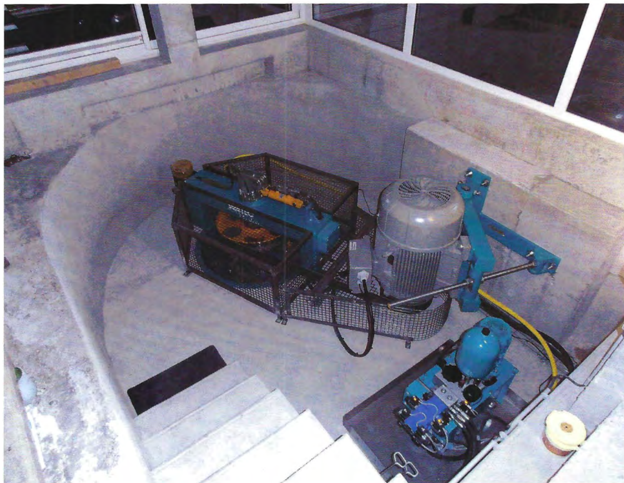
Avec ses frères et son cousin maçon, René Cachard a réalisé le génie civil pour installer, dans sa véranda, une turbine Kaplan double réglage de 34 kW. Photo : Watec Hydro
