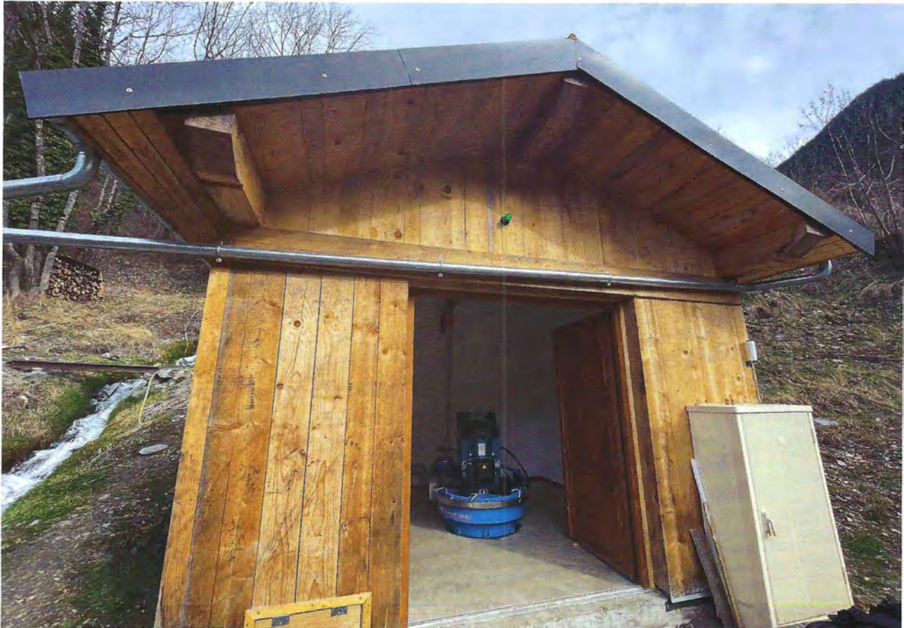
Les turbines de petites puissances sont en partie standardisées et souvent livrées clé-en-main avec la génératrice, le contrôle-commande et l'armoire électrique. Ici, la centrale de Claude Glise (lire en page 48). Photo : Irem
