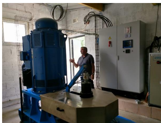
M. de Césaré devant sa turbine
