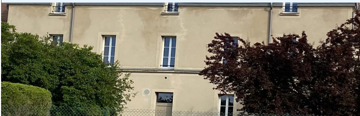
Photo du 12 mai 2026 : après la rénovation de la toiture, d'importantes traces d'humidité sont visibles uniquement sur la façade côté tennis.
