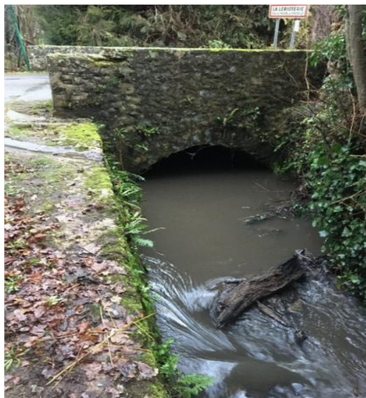
26) 27.01.2020 EAU NOIRE du RHODON en aval et BOUES en amont du pont de la LORIOTERIE, communes de MILON-la-CHAPELLE et De ST-LAMBERT-des-BOIS
