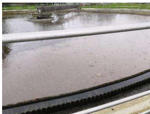
Surnageant et floccule de boues sur le clarificateur
