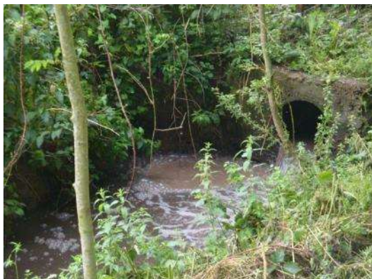
Sortie de buse : eau chargée de boues
