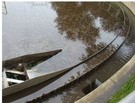
Clarificateur 1 : constat de rejet de flocons de boues en sortie de clarificateur
