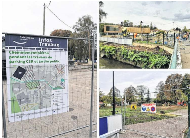
Le centre-ville de Saint-Rémy-lès-Chevreuse, notamment le parking du C3R et le jardin public, est en travaux depuis fin octobre, et ce pour une période de 6 mois.
