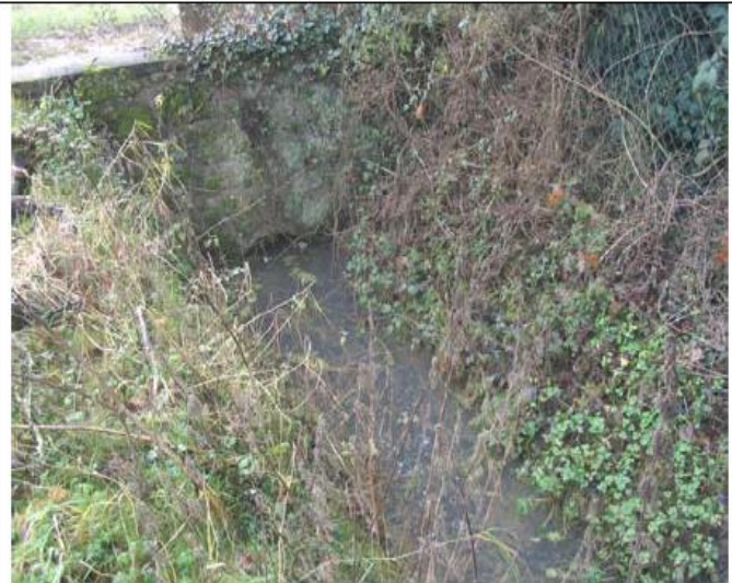
Envasement au 3/4 de la buse sous le chemin agricole
