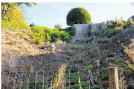
Des associations tirent la sonnette d'alarme sur la détérioration du chemin Jean-Racine.
