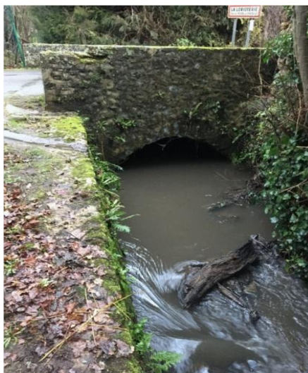
24) 27.01.2020 EAU NOIRE en AVAL et BOUES en AMONT du PONT de la LORIOTERIE
