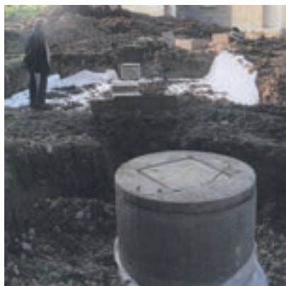
Les fosses sont en béton ou en PVC.
