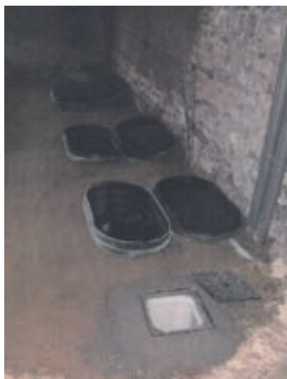
Cette micro-station comporte trois éléments, disposés en série, dans la grange
