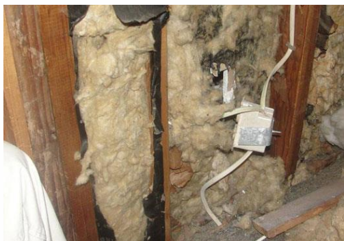
Photo : Laine de verre dégradée, sans frein-vapeur
