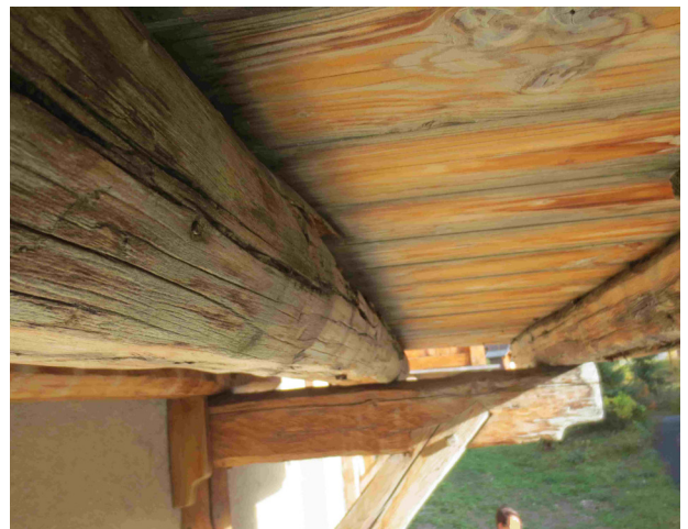
Dégradation de structure porteuse de balcon en bois par attaque (Crédit photo : Saretec)
