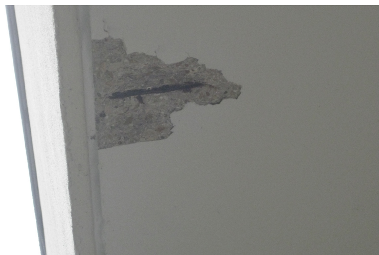
Éclatement en sous-face de balcon par corrosion d'armatures. (Crédit photo : Eurisk)
