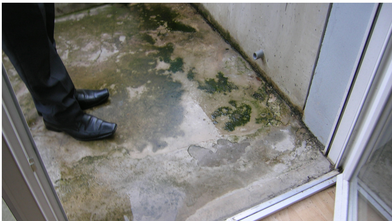
Absence d'étanchéité au niveau du seuil de balcon (Crédit photo : AQC)
