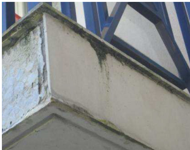
Décollements de revêtements en rives de nez de balcon (Crédit photo : Eurisk)
