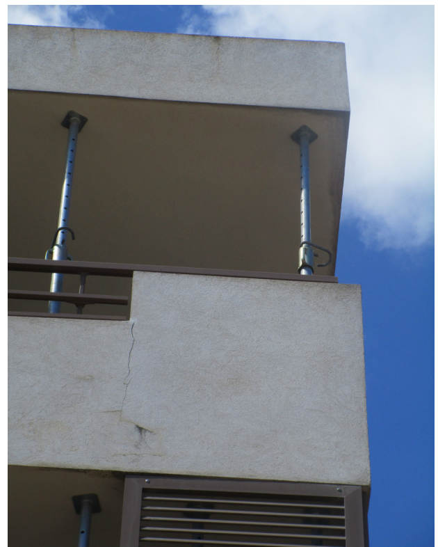
Fissuration d'un angle de balcon filant liée à un positionnement incorrect des armatures de reprise du double porte-à-faux (Crédit photo : Eurisk)
