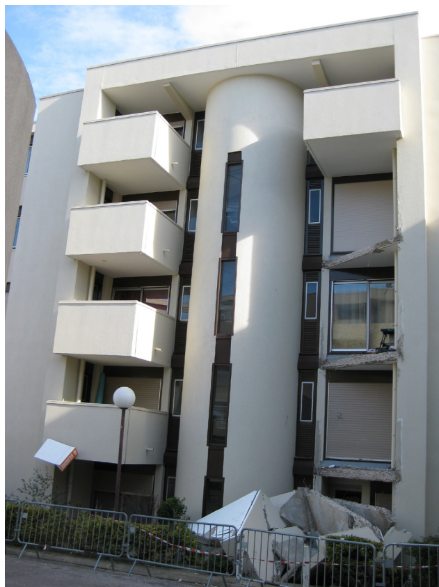
Effondrement d'un balcon (Crédit photo : AQC)
