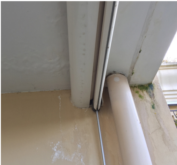
Infiltrations en sous-face de balcon par fissuration en cueillie latérale (Crédit photo : Socabat)
