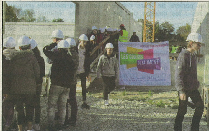
Des jeunes Haut-Marnais ont visité le chantier du futur centre aquatique de Bar-sur-Aube.
