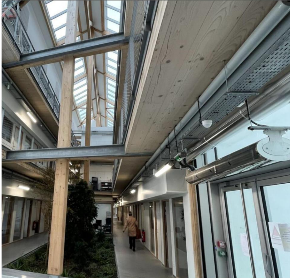
Des malfaçons par milliers... Photo ER/Eric BARBIER
