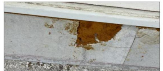
De nombreuses reprises de l'isolation extérieure sont à effectuer. Photo ER/Eric BARBIER
