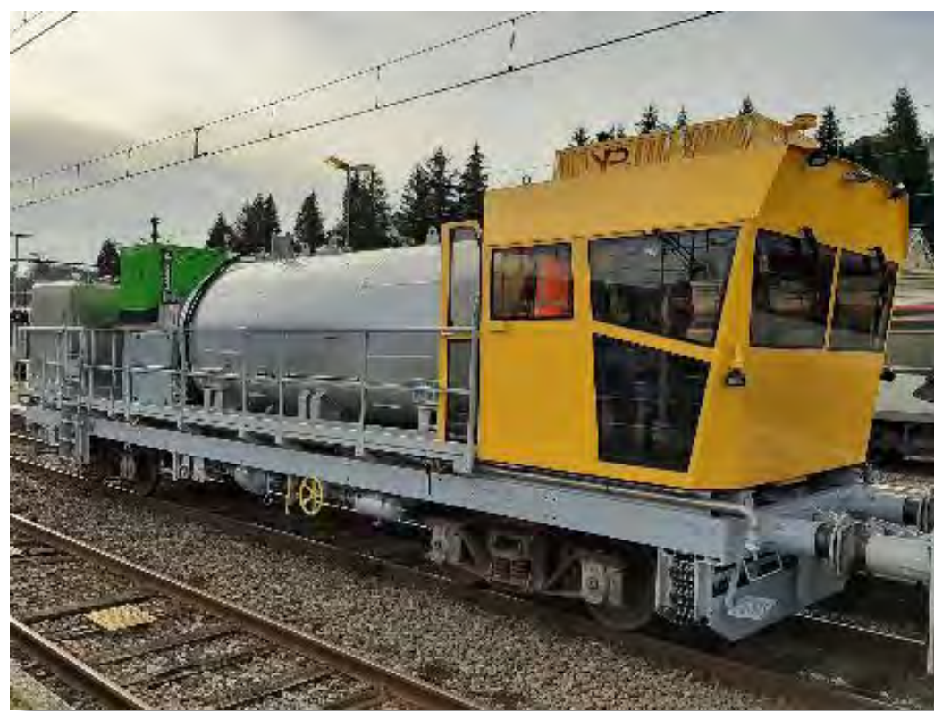
Traitement jusqu'à 45 km/h
