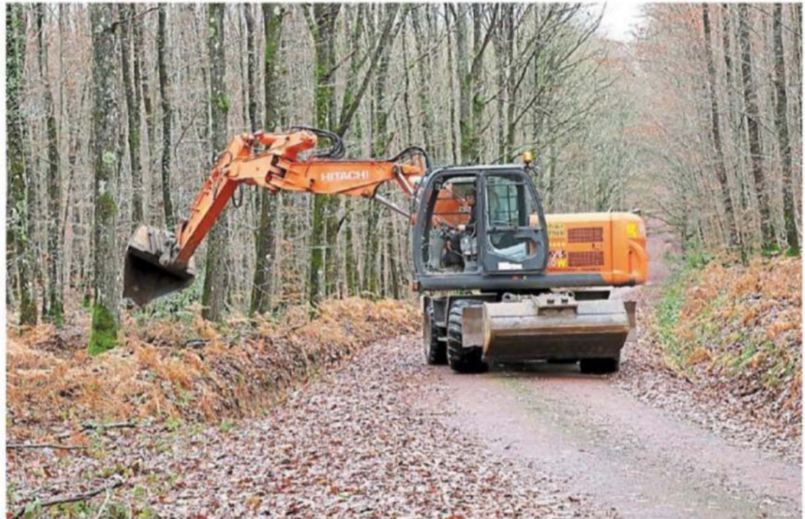
À l'approche de la fontaine de la Coudre, les travaux ont débuté.
