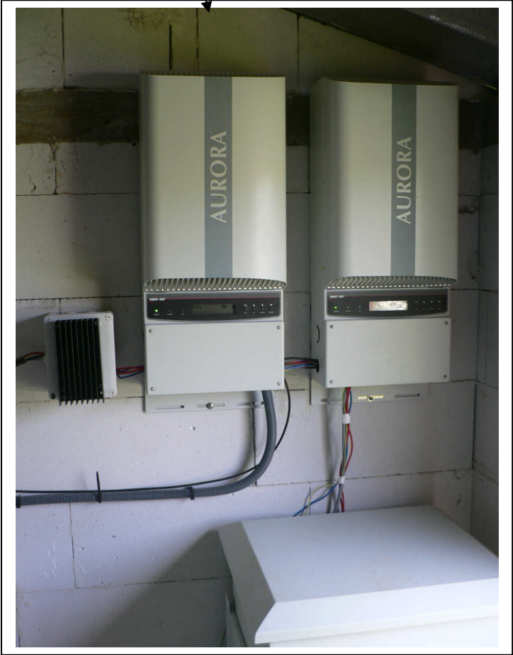
Exemple de branchement d'onduleur sur une ES 10 (sur l'image, il s'agit de 2 onduleurs 6 KW)
