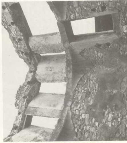
Photo 2 Le moulin. Vue des boîtes baises et des échappements d'air en terre cuite.
