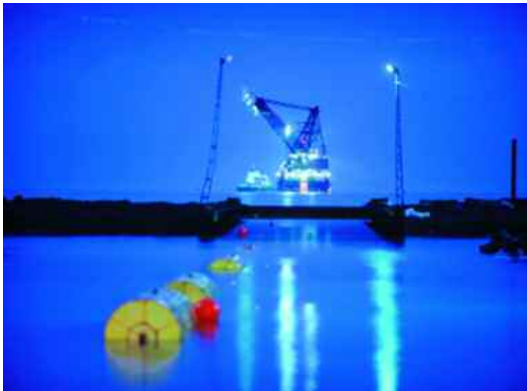
Blue Stream: la nave posatubi e sollevamento strutture della flotta Saipem CASTORO OTTO a Samsun durante le operazioni di tiro a riva, (© Eni).
